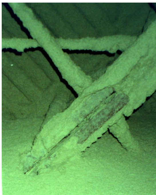
Exemplu de apariție a efectului de corodare în cazul unui cablu acoperit cu spuma anti-foc în Canada (2000, Ontario, Cambrian College).
